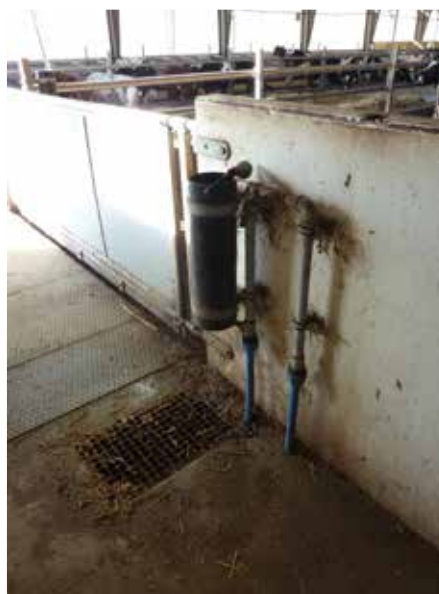
Figur 3.5 Håndvask med koldt og varmt vand, sæbe og (papir-)håndklæde, samt støvlevask som her, forhindrer chaufføren i at slæbe smitte med videre til næste besætning.
