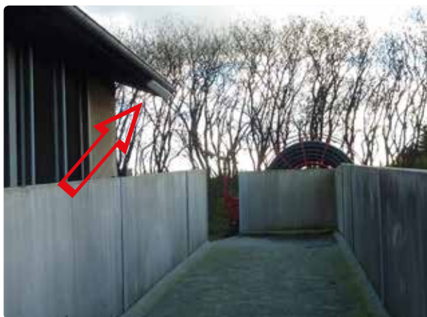
Figur 5.33 For enden af rampen er der monteret lys under udhænget (rød pil), så dyrene kan se, hvor de går, og chaufføren kan se, at han får dem alle med.
