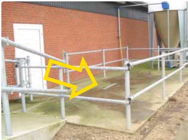
Figur 5.28 I selve udleveringsboksen er det betonbund med fald til afløb (gul pil).
